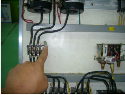
3 拉高壓壓力開關 (停止運轉)
