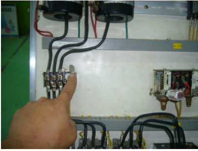
3 拉高壓壓力開關 (停止運轉)
